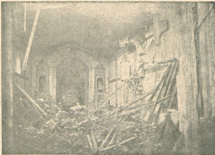
Interior, em ruínas, da igreja da Vila Militar
