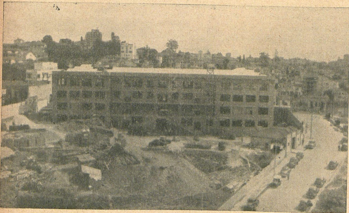
A 26 de maio, por ocasião do singelo ato de cobertura final do edifício, pudemos focalizar a esplêndida realidade em que vem se transformando a decisão do govêrno paulista.
