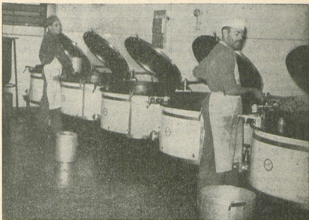
Linha de caldeirões a vapor, em número de 10, para o cozimento dos alimentos. Também são da afamada marca WALLIG, indispensáveis às cozinhas coletivas, do gênero da que vem de ser instalada na Fôrça Pública.
